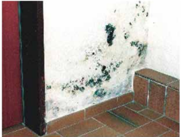
hongo formado en las paredes
